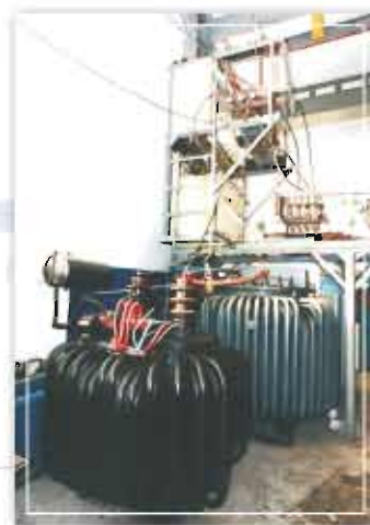
Источник высокого напряжения: переменного – до 10 кВ, постоянного – до 30 кВ
