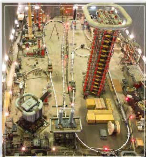
Ресурсные испытания кабельной системы 330 кВ
