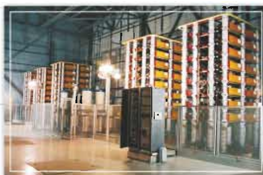
Вентильный зал комплектного высоковольтного преобразовательного устройства ПС Выборгская
