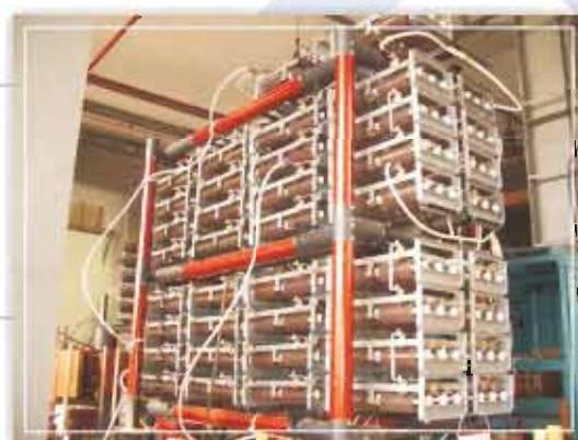
Резистивная низкоомная нагрузка мощностью до 2 МВт
