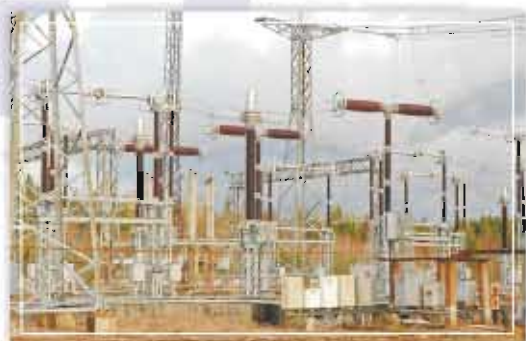
ОРУ 330 кВ ПС Выборгская
