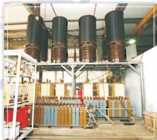
Высоковольтные воздушные реакторы с суммарной индуктивностью до 300 мГн
