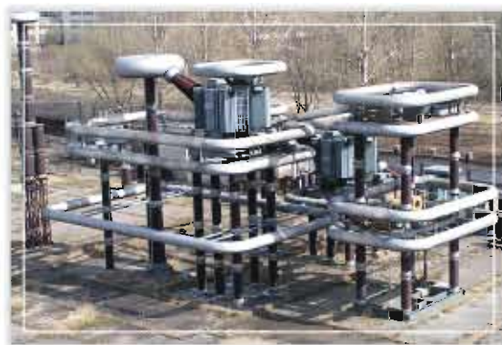
Каскад испытательных трансформаторов 3х600 кВ, 3,3 А
